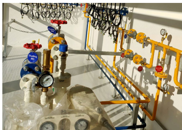
BỆNH VIỆN TRƯỜNG ĐẠI HỌC TOKYO-NHẬT BẢN HOSPITAL OF TOKYO UNIVERSITY - JAPAN Hệ thống gas Gas system
