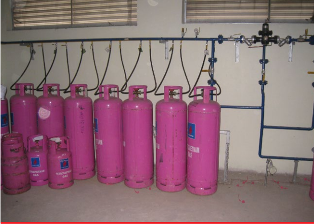
NHÀ MÁY FUJI INNOVATION - NHẬT BẢN FUJI INNOVATION FACTORY – JAPAN Trạm cấp gas Gas supply station
