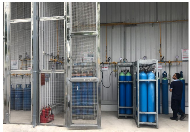
ABB BẮC NINH ABB BAC NINH Hệ thống cung cấp gas và khí O 2 , CO 2 , Ar, Arkan O 2 , CO 2 , Ar, Arkan gas supply system
