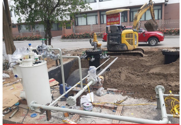
NHÀ MÁY RICHY MIỀN BẮC-THẠCH THẮT - HÀ NỘI RICHY NORTHERN FACTORY – THACH THAT – HANOI Bồn gas ngầm 10 tấn 10-ton underground gas tank
