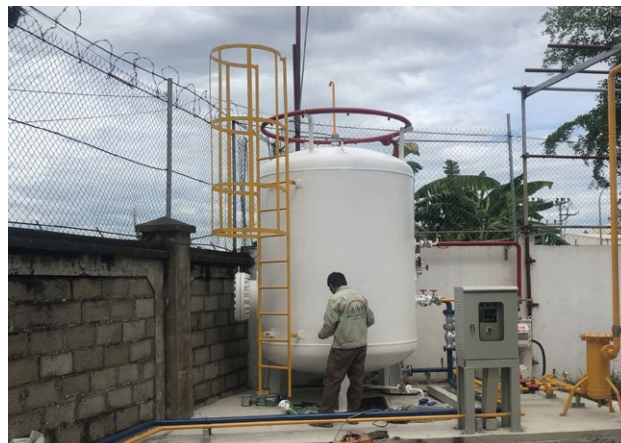
NHÀ MÁY NHÔM LIÊN HOA LIEN HOA ALUMINUM FACTORY Hệ thống gas Gas system
