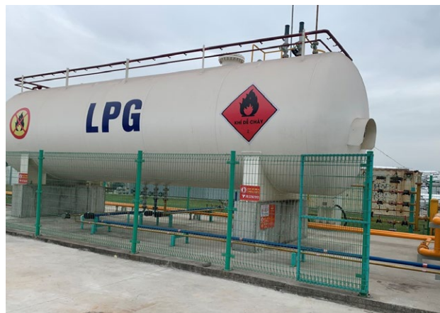
NHÀ MÁY SHINYANG VINA-HÀN QUỐC SHINYANG VINA FACTORY - KOREA Hệ thống gas Gas system
