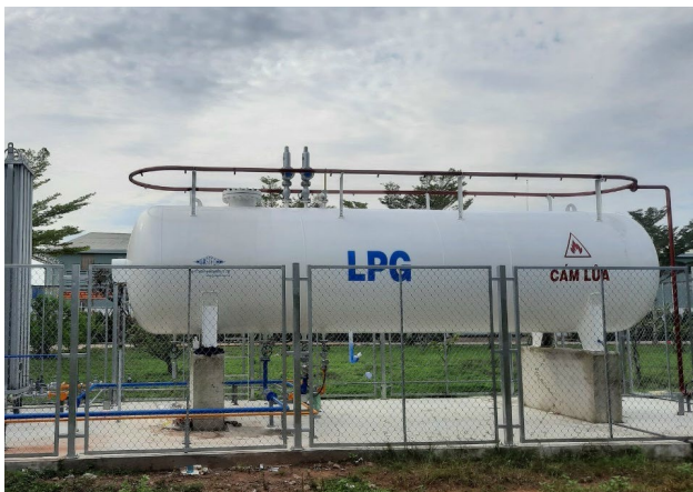
NHÀ MÁY EIKODO-NHẬT BẢN EIKODO FACTORY - JAPAN Bồn gas và máy hoá hơi tự nhiên Gas tank and natural vaporizer
