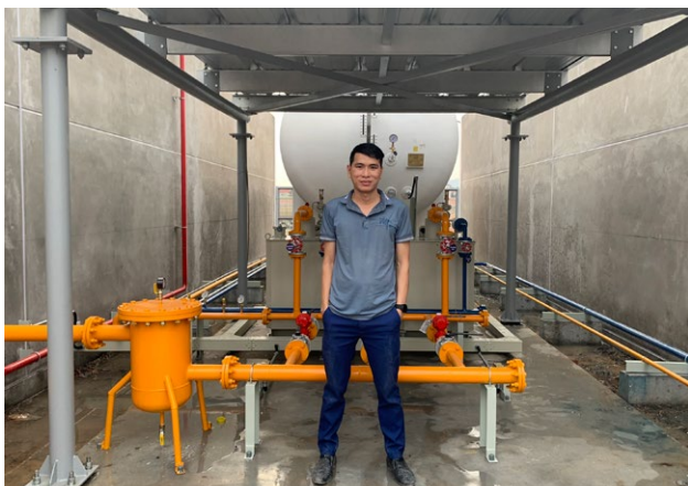
NHÀ MÁY SUMIRIKO-NHẬT BẢN SUMIRIKO FACTORY – JAPAN Hệ thống bồn gas 18 tấn 18-ton gas tank system
