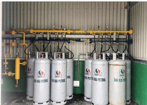
CÔNG TY JEIL-TECH VINA JEIL-TECH VINA COMPANY Hệ thống gas Gas system
