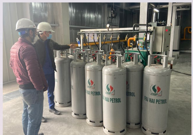
KIỂM TRA AN TOÀN, BẢO DƯỠNG MIỄN PHÍ HỆ THỐNG GAS CỦA KHÁCH HÀNG Safety check, Free maintenance of customer's gas system
