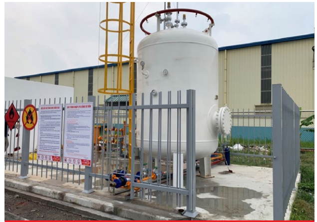
NHÀ MÁY POLYPIA-KCN TIÊN DƯ POLYPIA FACTORY – TIEN DU INDUSTRIAL PARK Bồn gas 3 tấn 3-ton gas tank
